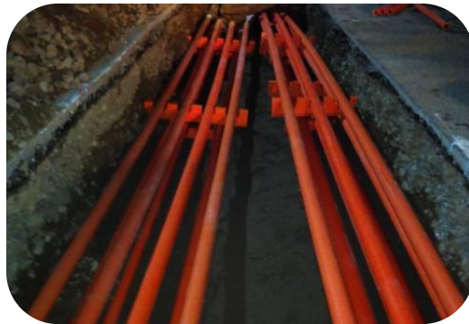
Bancos de ductos
