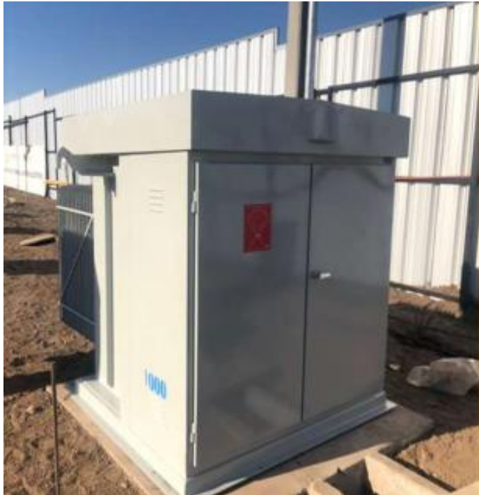
Instalación a la interperie
